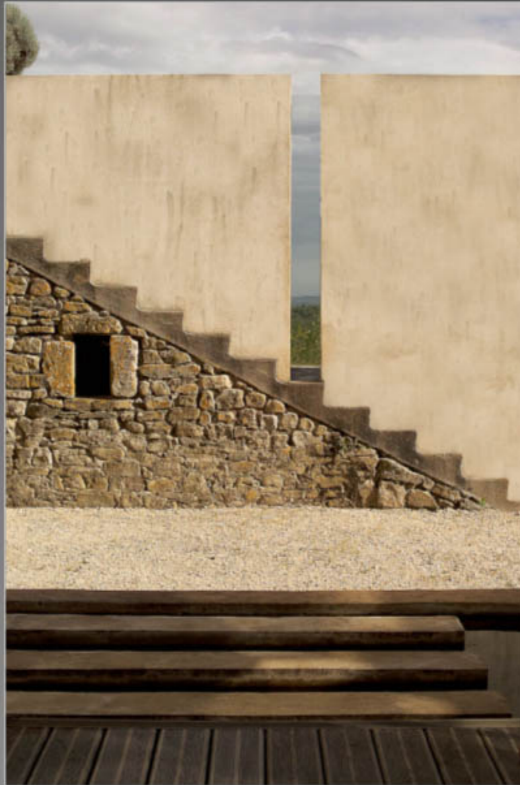
...ou encore par la fendasse du mur d'enceinte
